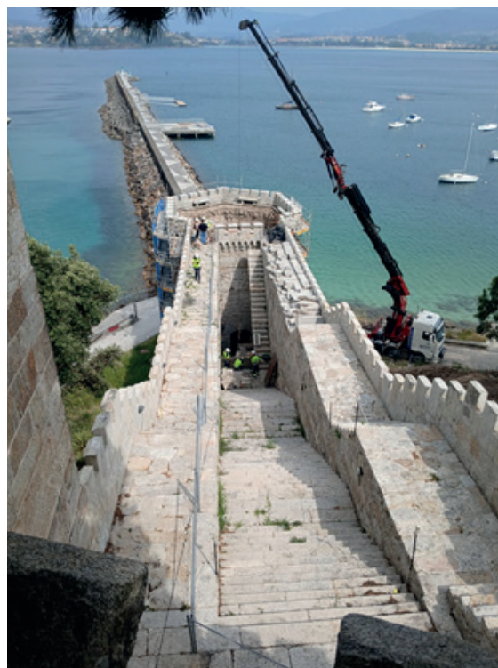
Figura 9. Torre de la Tenaza de la fortaleza de Monterreal durante los trabajos de limpieza y conservación
